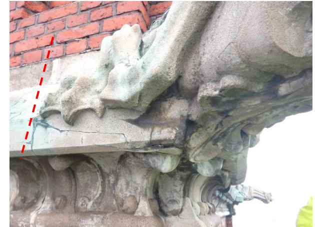
Gargoilien alaosissa esiintyy halkeamia ja rapautumaa. Gargoilit ovat yhtenäistä betonivalua jalkaosaan saakka (punainen katkoviiva).
