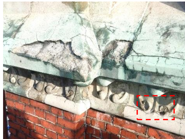
Betonin halkeilua ja paloina kuoriutumista. Alapuolisen osan laastisia puolipallokoristeissa ei ole tartuntateräksiä muuhun nauhaan. Osa koristeista on rapautunut ja joko pudonnut tai irtosi kevyesti vasa-roimalla (punainen nelikulmio).
