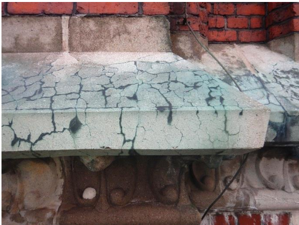
Betoninauhan viistetyin osan halkeilua. 90-luvun korjauksessa käytetty betoni on halkeillut kutistuesaan, mikä on johtanut rapautumiin.
