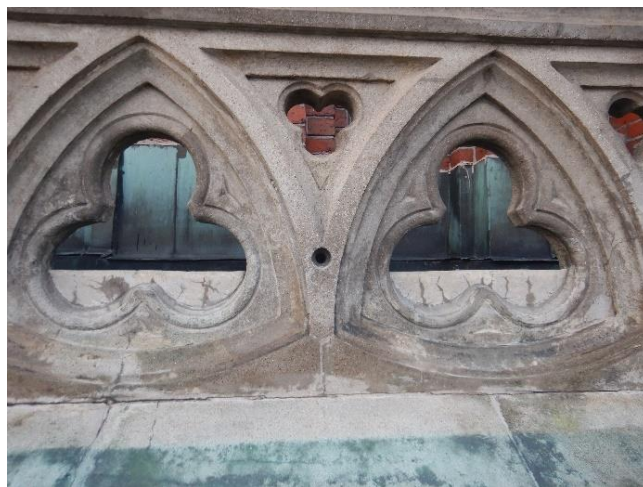
Halkeamia kaiteen betonissa. Tämä ilmeisesti korjattu 90-luvulla?
