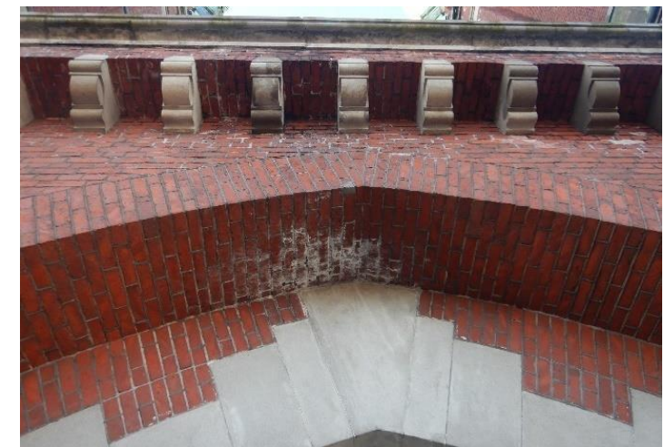
Kalkkihärmettä parvekkeen alapuolisissa julkisivupinnoissa.
