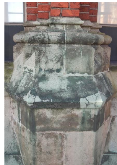
Betonin halkeilua ja kuparivalumiin värjäytymää pilasterin alaosassa.
