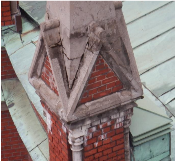
Kalkkivalumia tornin betoniosan alapuolisessa muurauksessa. Halkeamia betonin saumoissa.
