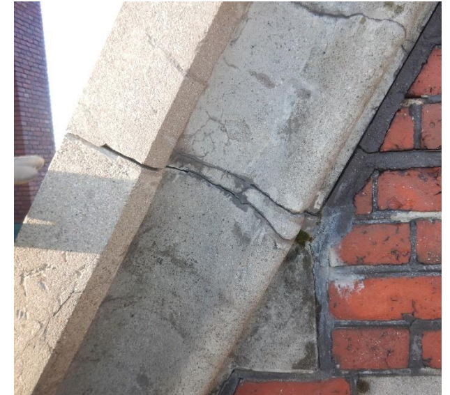
Halkeamia elementtien välisen kovan laastisauman vieressä.
