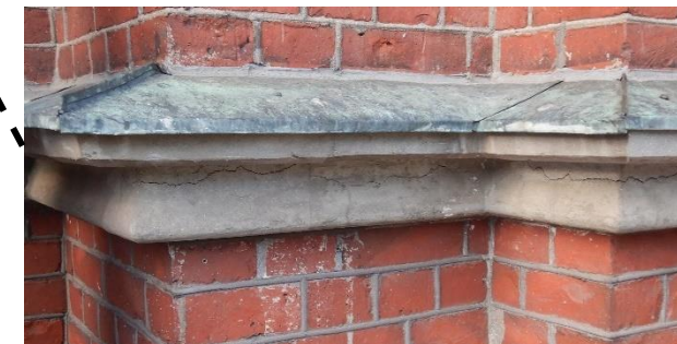
Halkeilua kerrosvesipellin alapuolisessa betonissa.
