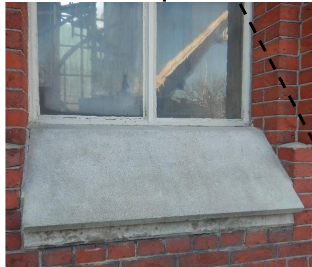
Ikkuna-aukon vedenohjaimet ovat hyvässä kunnossa, mutta reunojen kovissa laastisaumoissa havaittiin halkeamia.
