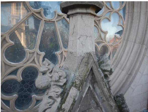
Sammalkasvustoa ja peseytynyttä pintaa todennäköisesti vanhemman osan betonissa (tummemmat alueet). Halkeamia todennäköisesti korjattuna yläosassa.
