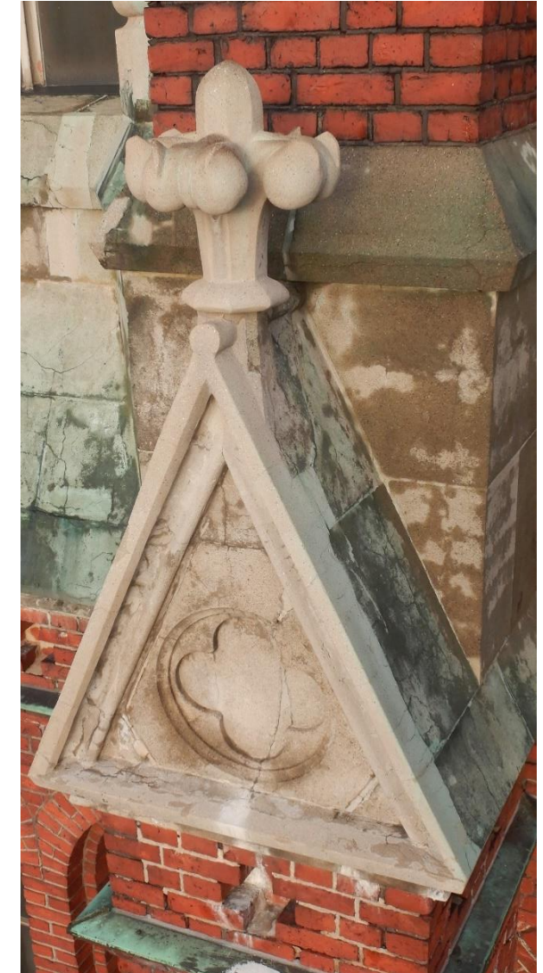
Pilasterin yläosan koristeaihio. Betoni halkeilee kolmion sisäpinnoissa. Raudoitustapa ei ole tiedossa.
