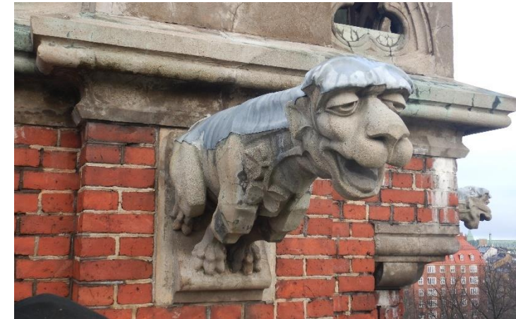
Halkeamia gargoilin jalassa sekä parvekekaiteen viiston osan ulkoreunassa. Yläpuolelle tehty lyijylevyeristys 90-luvulla.
