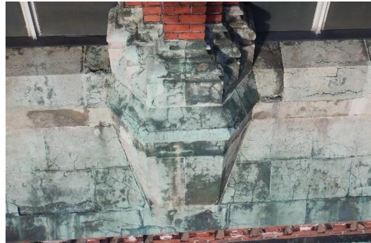
Betonin halkeilua, lohkeilua ja paloina kuoriutumista.
