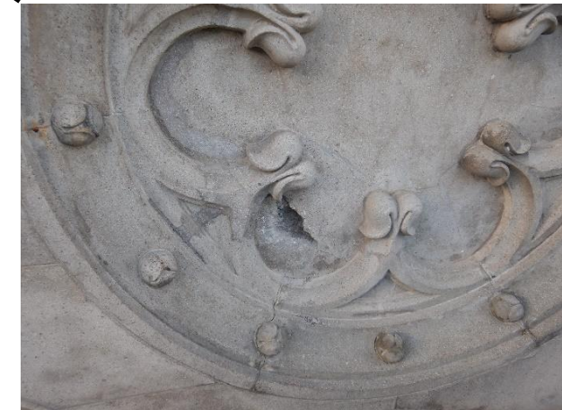
Betonin lohkeama korsteen syvennyksessä.
