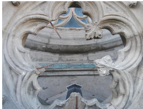
Ruostuneet lattateräkset ovat paisuessaan vaurioittaneet koristeaihion betonia.
