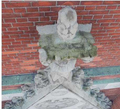
Leväkasvustoa ja halkeilua korsteen vaakapinnoilla. Yksittäisiä todennäköisesti uusittuja tiiliä korsteen takana julkisivussa.
